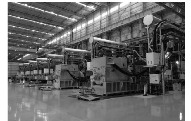
増築部には試運転用の定盤8面を追加設置した
